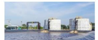
ระบบบำบัดน้ำเสียแบบเติมอากาศ Activated Sludge
