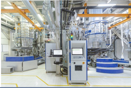
Exhibit 11: เครื่องจักรบางส่วนภายในโรงงาน
