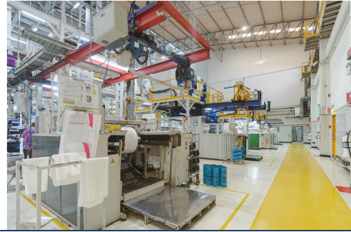
Exhibit 12: เครื่องจักรบางส่วนภายในโรงงาน
